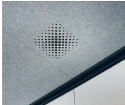
Die Frischluft wird über einen in der Akustikdecke integrierten und unsichtbaren Schalldämpfer in den Raum gezogen
